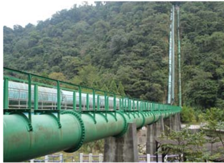
圖-位於抽藤坑溪的二號倒虹吸管。
